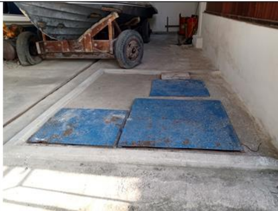
Bacia de contenção e caixa separadora
