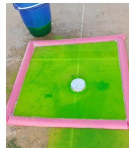
Foto N° 34 Data: 27/07/2021 Anomalia: Ensaio com traçador químico com ralo tamponado para verificar estanqueidade da laje
