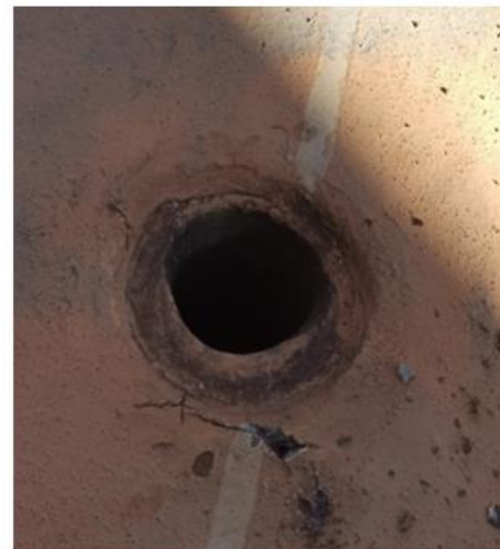
Foto N° 33 Data: 26/07/2021 Anomalia: Presença de fissuras próximas ao ralo
