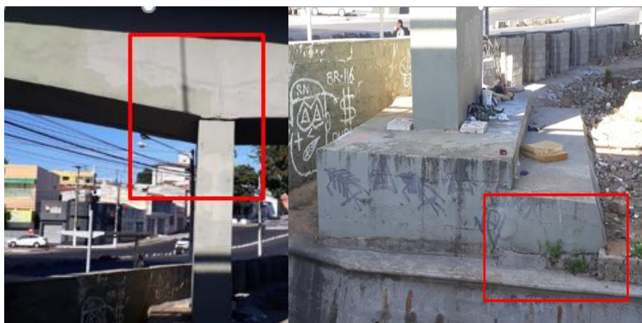
Figura 03 - Pilar fora do prumo, recalque, fissuração acima do Neoprene. Fonte: Autores (2020).
