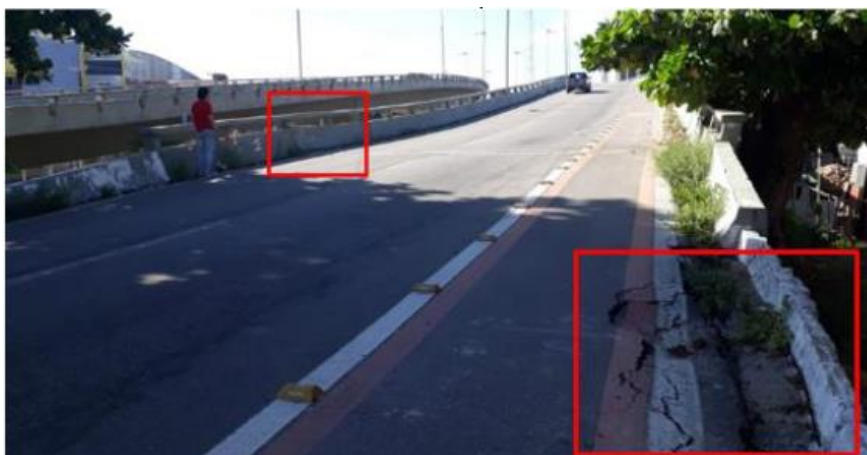
Figura 07 - Guarda roda e guarda corpo em desacordo com a norma vigente; Fissuras e afundamento no pavimento.
