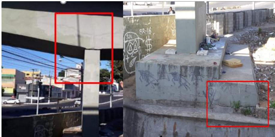
Figura 05 - Pilar fora do prumo, recalque, fissuração acima do Neoprene. Fonte: Autores (2020).
