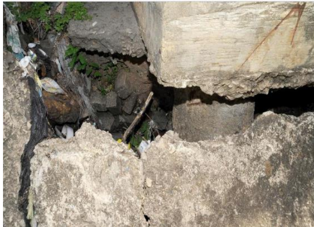
Figura 04 - Estaca e bloco do pilar com recalque. Fonte: Autores (2020).
