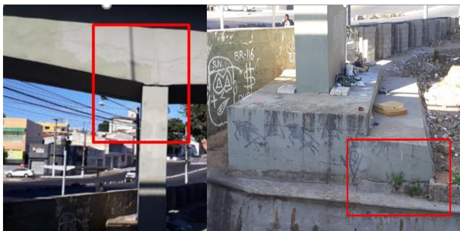
Figura 01 - Pilar fora do prumo, recalque, fissuração acima do Neoprene. Fonte: Autores (2020).
