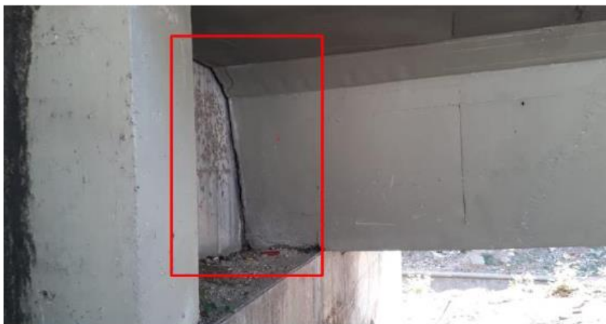
Figura 06 - Flecha de ordem 14cm com rachadura na junção do aterro com a viga. Fonte: Autores (2020).
