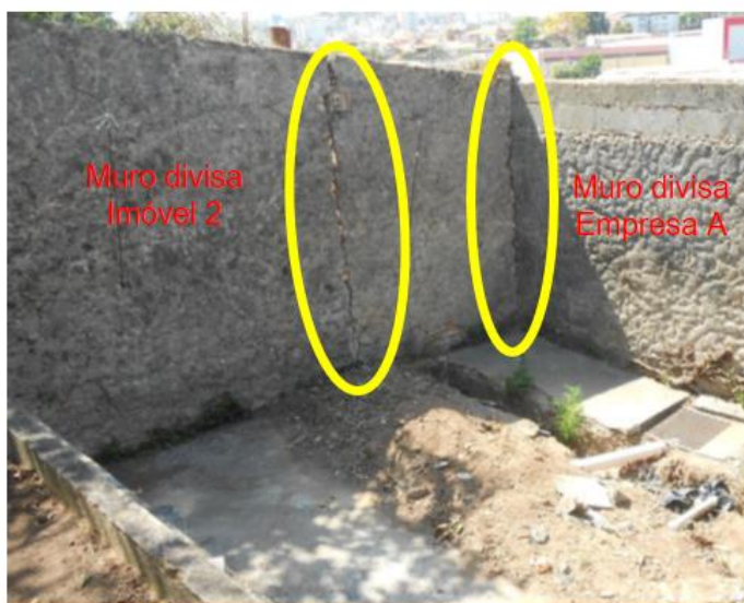
Brecha e fenda nos muros de divisa
