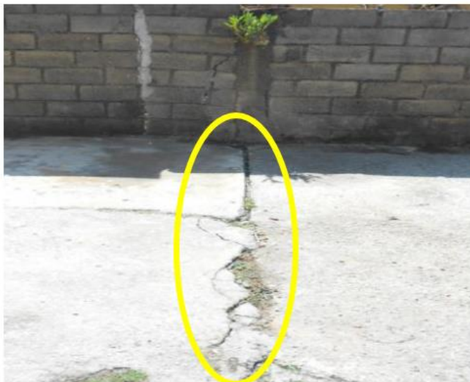
Fissura, trincas, rachaduras e abatimentos no piso do imóvel 5
