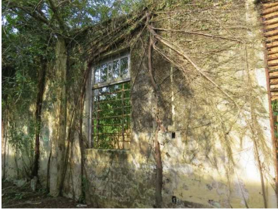
Figura 40 - Face interna. Notar crescimento intenso de arbustos, na parede e sobre a janela
