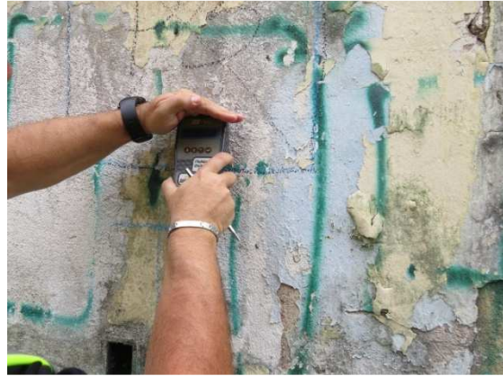
Figura 35 - PAREDE LATERAL ESQUERDA. Face interna. Medição de umidade
