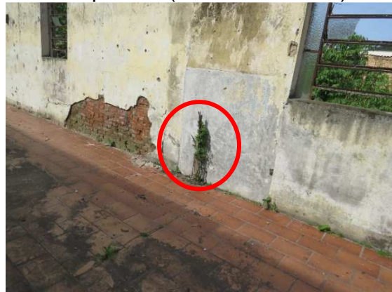
Figura 43 - Parede lateral direita. Face interna. Notar crescimento de arbusto, na base da parede (círculo vermelho)
