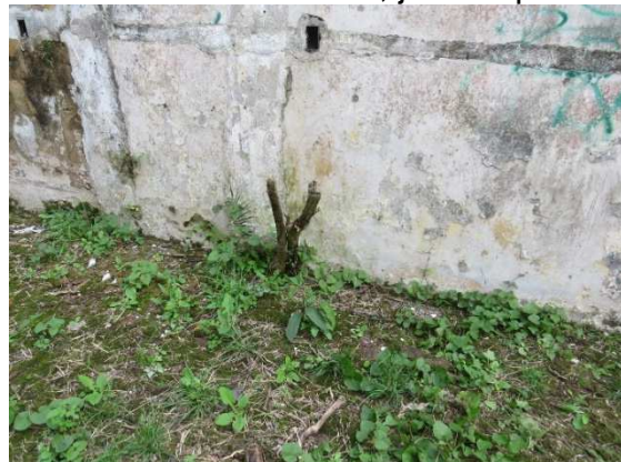
Figura 33 - PAREDE LATERAL ESQUERDA. Face interna. Notar crescimento de arbusto, junto à parede
