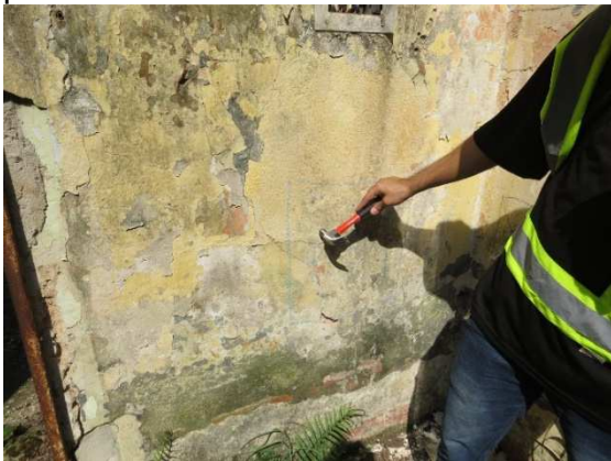
Figura 48 - PAREDE LATERAL DIREITA. Face interna. Teste de percussão
