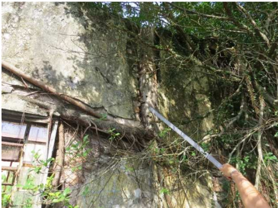
Figura 42 - Parede lateral direita. Face interna. Notar crescimento intenso de vegetação por entre a alvenaria, onde remanesciam resquícios de antigo pilar em madeira
