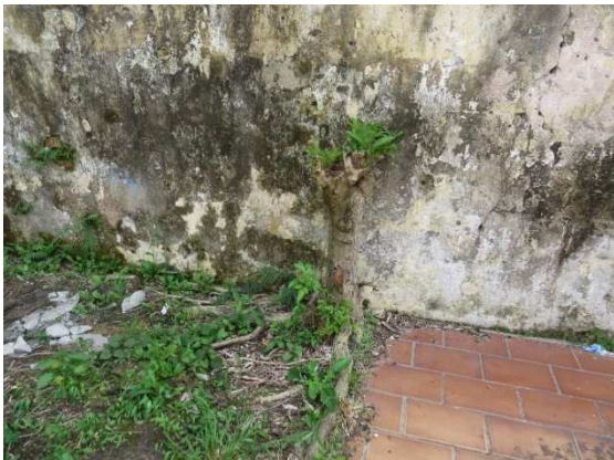
Figura 32 - PAREDE LATERAL ESQUERDA. Face interna. Notar crescimento de arbusto, junto à parede
