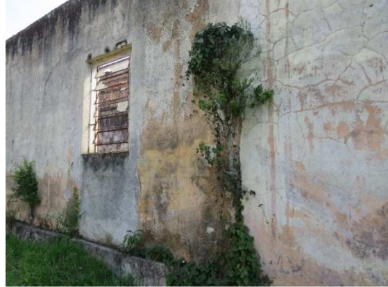
Figura 53 - PAREDE LATERAL DIREITA. Face externa. Notar desenvolvimento de arbusto, sobre a parede
