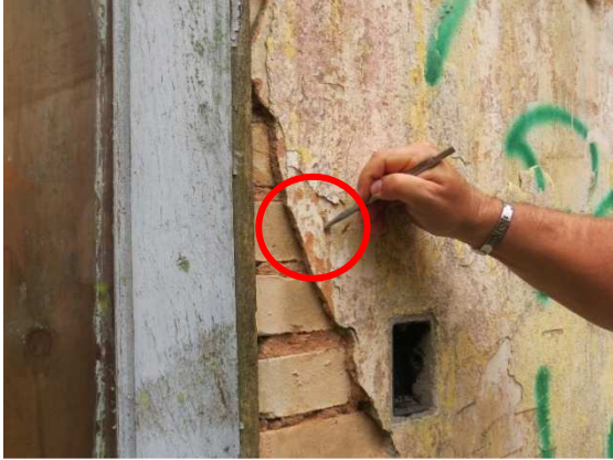
Figura 22 - FACHADA FRONTAL. Face interna. Teste de resistência ao risco (círculo vermelho)
