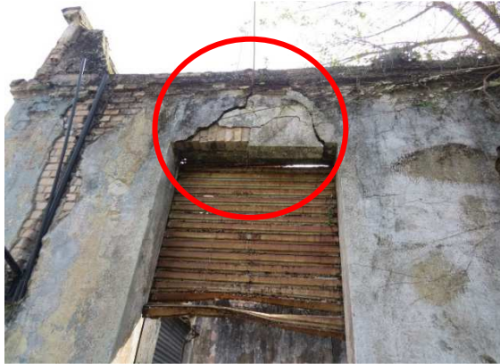
Figura 58 - PAREDE LATERAL DIREITA. Face externa. Fissuração sobre a janela (círculo vermelho)
