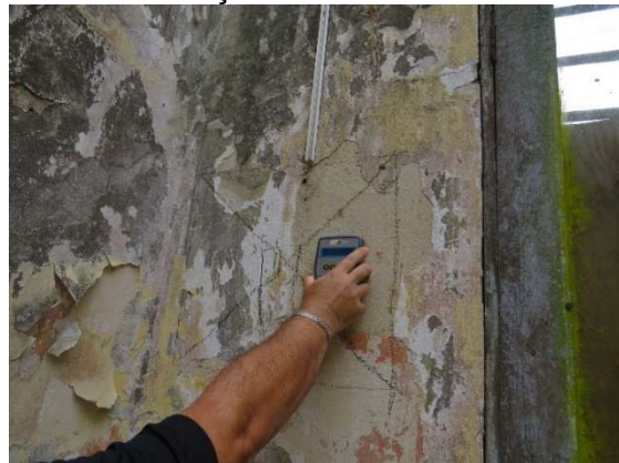
Figura 27 - FACHADA FRONTAL. Face interna. Medição de umidade
