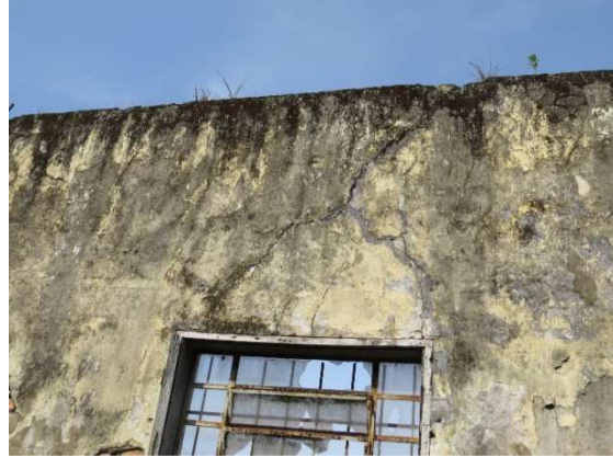
Figura 47 - PAREDE LATERAL DIREITA. Face interna. Detalhe da figura anterior, indicando ruptura da alvenaria
