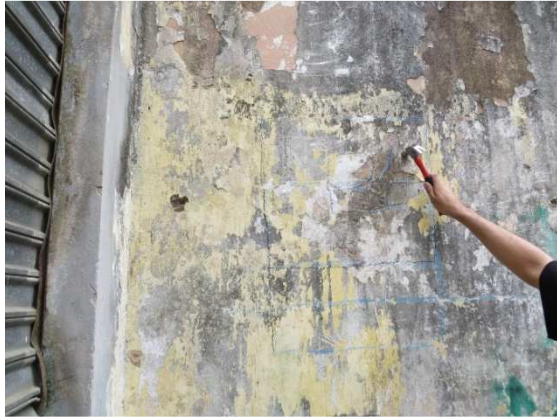
Figura 34 - PAREDE LATERAL ESQUERDA. Face interna. Teste de percussão
