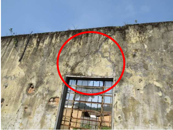
Figura 46 - PAREDE LATERAL DIREITA. Face interna. Fissuração sobre a janela (círculo vermelho)
