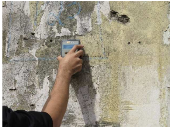
Figura 49 - PAREDE LATERAL DIREITA. Face interna. Medição de umidade
