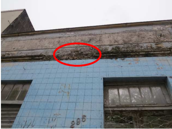
Figura 10 - FACHADA FRONTAL. Face externa. Sanca quebrada (círculo vermelho)
