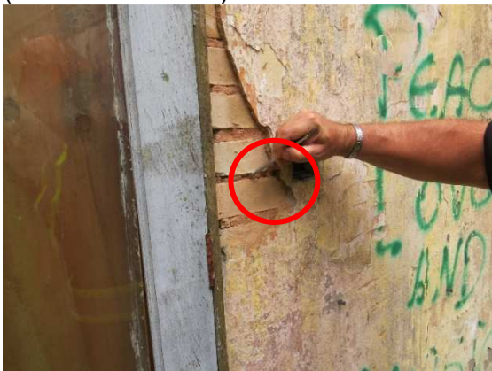
Figura 20 - FACHADA FRONTAL. Face interna. Teste de resistência ao risco (círculo vermelho)
