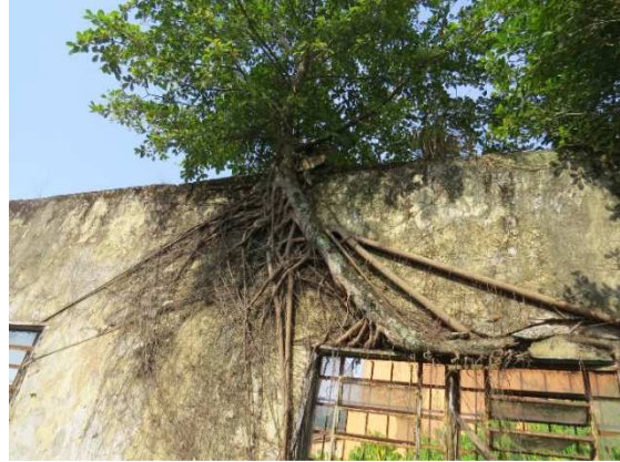
Figura 41 - Parede lateral direita. Face interna. Notar crescimento intenso de arbustos, na parede
