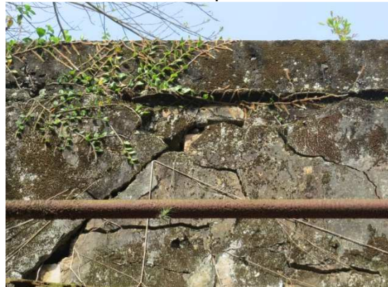
Figura 45 - PAREDE LATERAL DIREITA. Face interna. Detalhe da figura anterior, indicando ruptura da alvenaria
