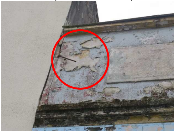
Figura 12 - FACHADA FRONTAL. Face externa. Descascamento da pintura (círculo vermelho)
