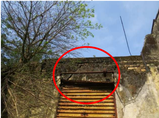
Figura 44 - PAREDE LATERAL DIREITA. Face interna. Fissuração intensa sobre a porta (círculo vermelho)
