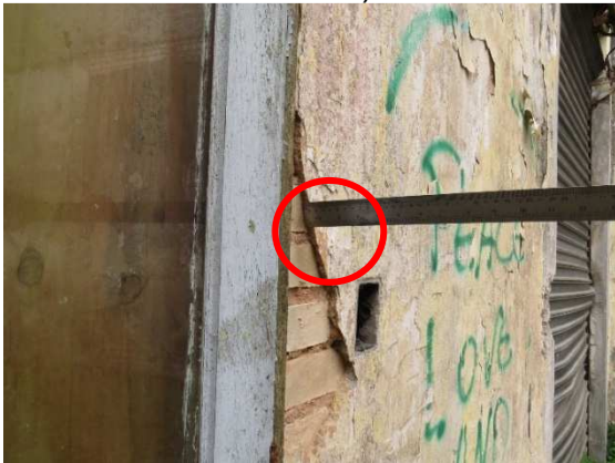
Figura 24 - FACHADA FRONTAL. Face interna. Espessura do reboco (aprox. 1cm - círculo vermelho)
