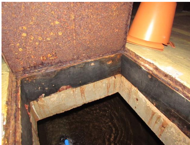
Figura 9 – Vista da corrosão da tampa de ferro fundido (autoria própria).
