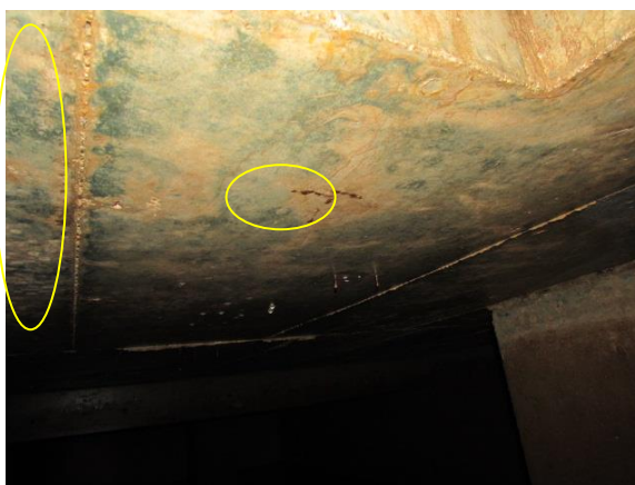
Figura 21 – Superfície superior do reservatório sem impermeabilização e com ferragem exposta (autoria própria).
