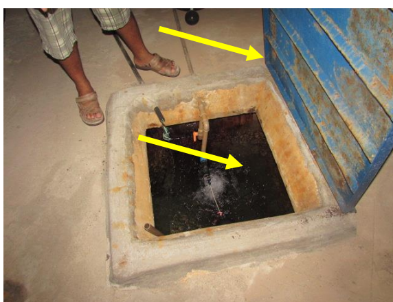
Figura 16 – Corrosão da tampa do reservatório por ausência de proteção e presença da madeira da fôrma que não foi retirada após a cura do concreto (autoria própria).
