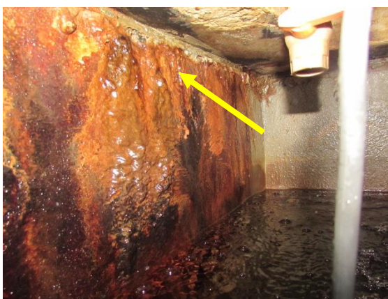
Figura 11 – Falha na impermeabilização das paredes do reservatório e infiltração da água do solo em contato direto com a água reservada (autoria própria).
