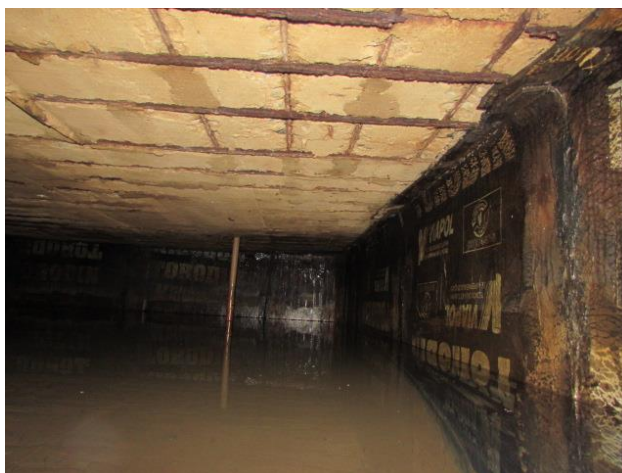
Figura 10 – Vista de impermeabilização inadequada (autoria própria)
