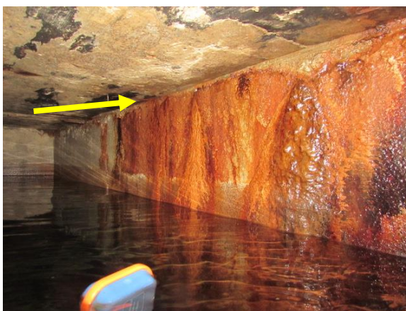
Figura 13 – Falha na impermeabilização das paredes do reservatório e infiltração da água do solo em contato direto com a água reservada (autoria própria).
