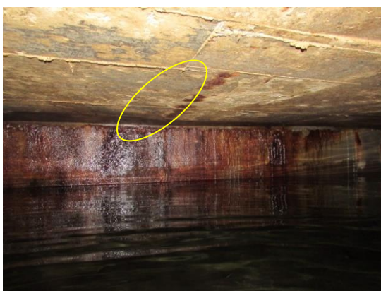
Figura 14 – Ausência de impermeabilização na superfície superior do reservatório enterrado e sinais de oxidação da armadura da laje (autoria própria).
