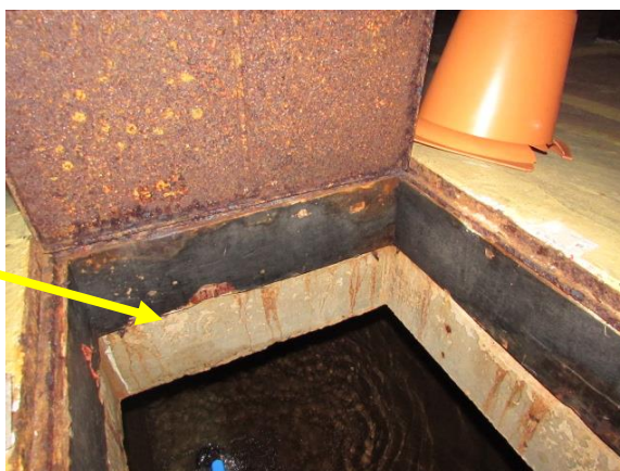
Figura 20 – Presença de folhas de Madeirit na tampa do reservatório (autoria própria).
