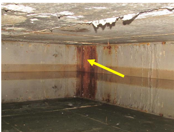
Figura 12 – Falha na impermeabilização das paredes do reservatório e infiltração da água do solo em contato direto com a água reservada (autoria própria).
