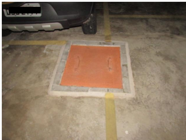
Figura 7 – Vista de tampa do reservatório inferior sem rebordo mínimo de 100 mm (autoria própria)
