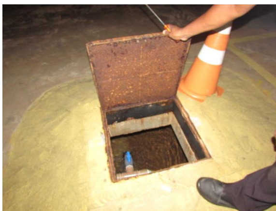
Figura 19 – Tampa do reservatório sem devida proteção anticorrosiva (autoria própria).
