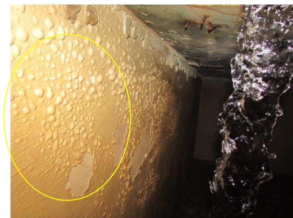
Figura 23 – Falha na impermeabilização das paredes do reservatório (autoria própria).
