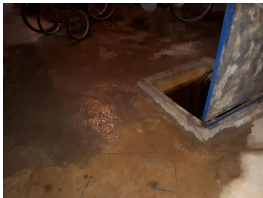
Figura 15 – Vista da água proveniente de inundação, empoeçada em cima da laje do reservatório inferior (autoria própria).
