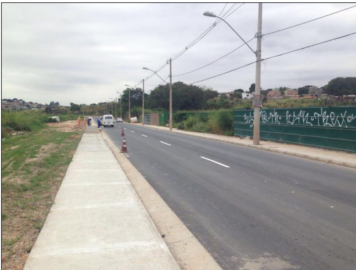
Figura 18: Mostra a Av. Juiz Marco Túlio Isaac em frente a área remanescente da Gleba 01 de 20/05/2016. (Fonte: Engenheiro Perito).
