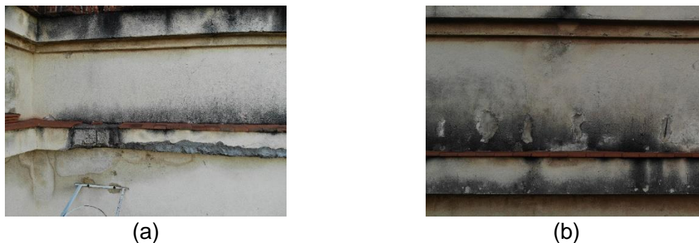
Figura 24 – Destacamento da camada de cobrimento do elemento de concreto armado e da argamassa de revestimento da fachada: (a) detalhe arquitetônico e (b) platibanda.
